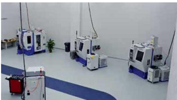
La nouvelle halle de démonstration de Willemin-Macodel SA dans les locaux du Swiss-Tech-Centers à Shanghai en Chine.
